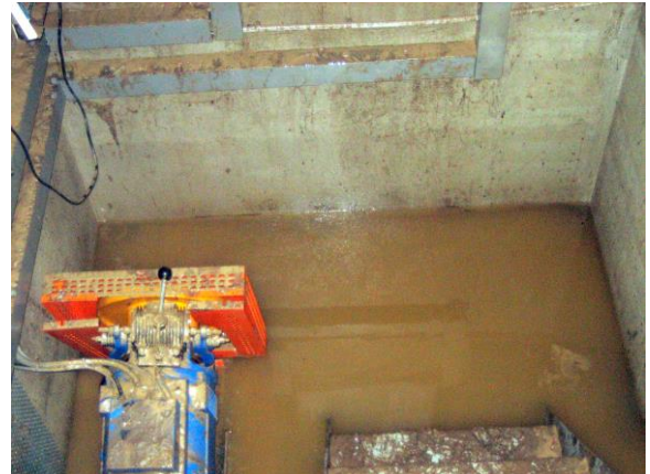
Der 8 Monate alte Lift muss total saniert werden.
