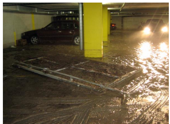
Das Tor hielt dem Wasserdruck nicht stand – es wurde vom Wasser in die Halle gespült.
