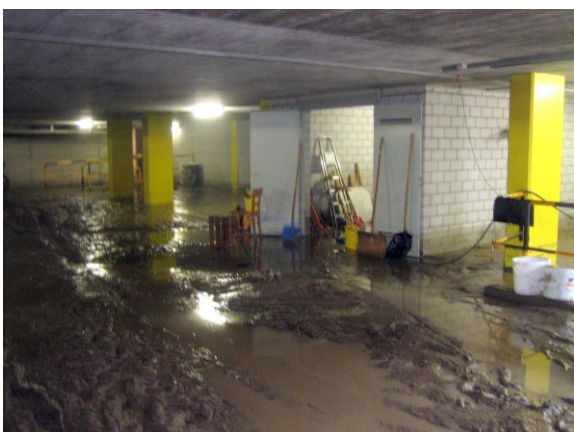
Schlamm und Dreck "so weit das Auge" reicht!
