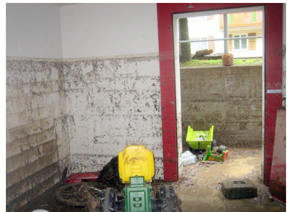
Die Eingangstüre wurde in den Raum gedrückt.
