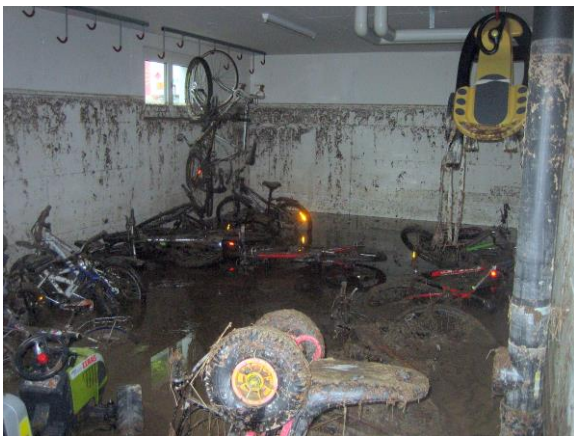
Chaos im Veloraum Schächli 19 nach dem Absaugen des Wassers.
